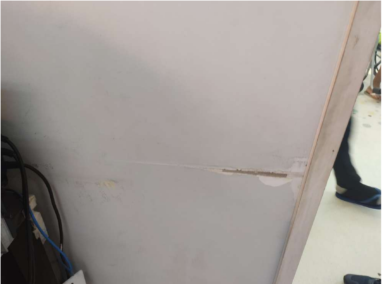
Detalhe de rachadura/junta em parede
