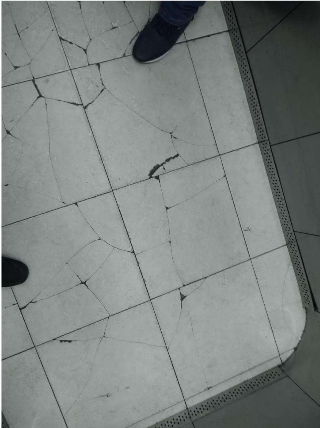
Piso do elevador danificado
