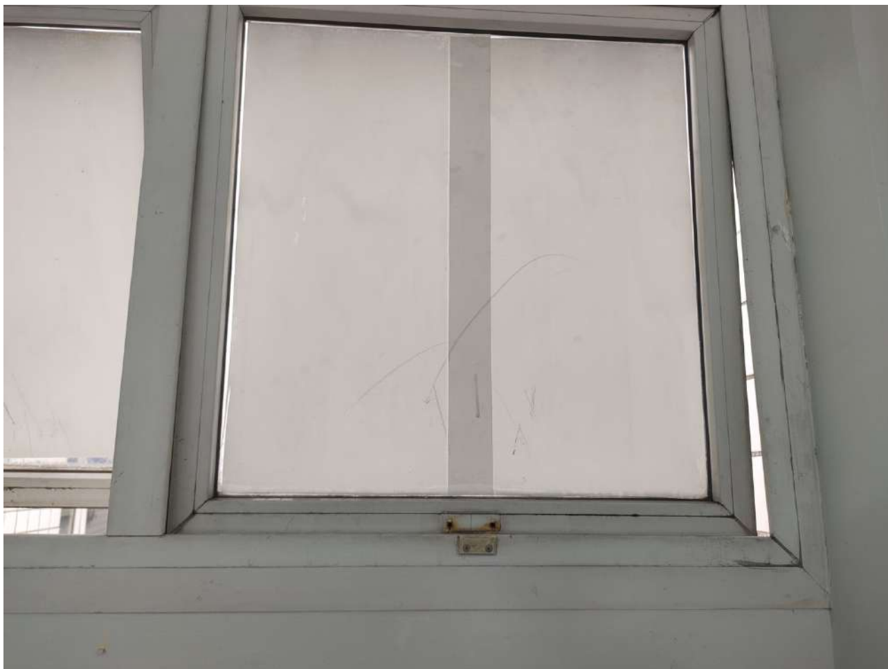
Janela basculante com vidro manchado e trinco ausente
