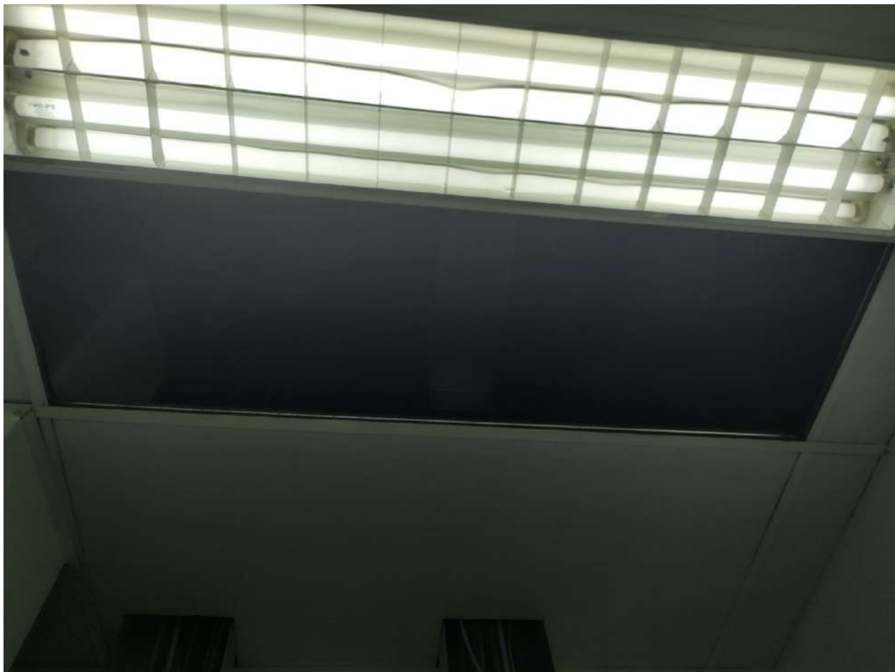
Placa de forro ausente
