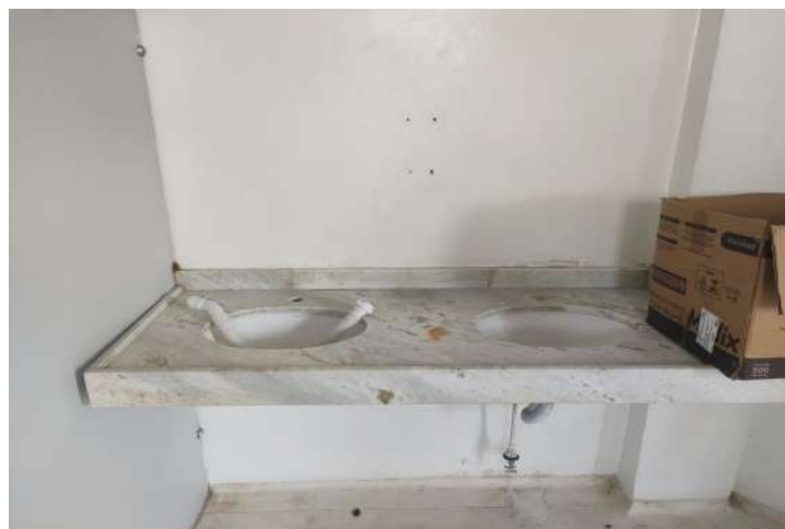
Torneiras ausentes em sanitário
