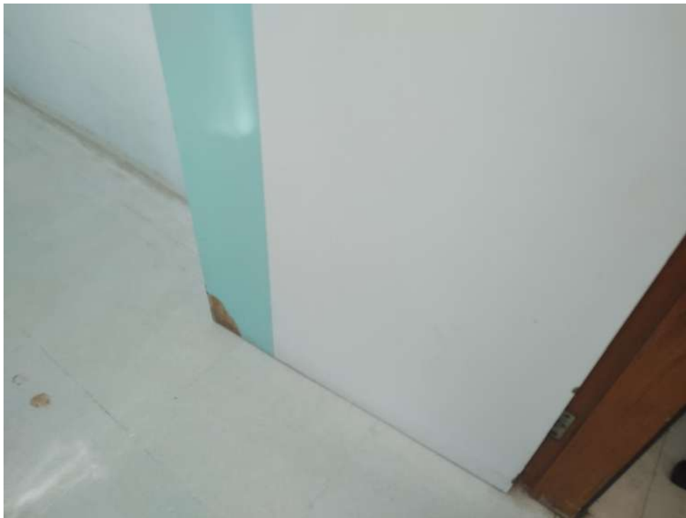
Canto inferior de revestimento de porta com descascado
