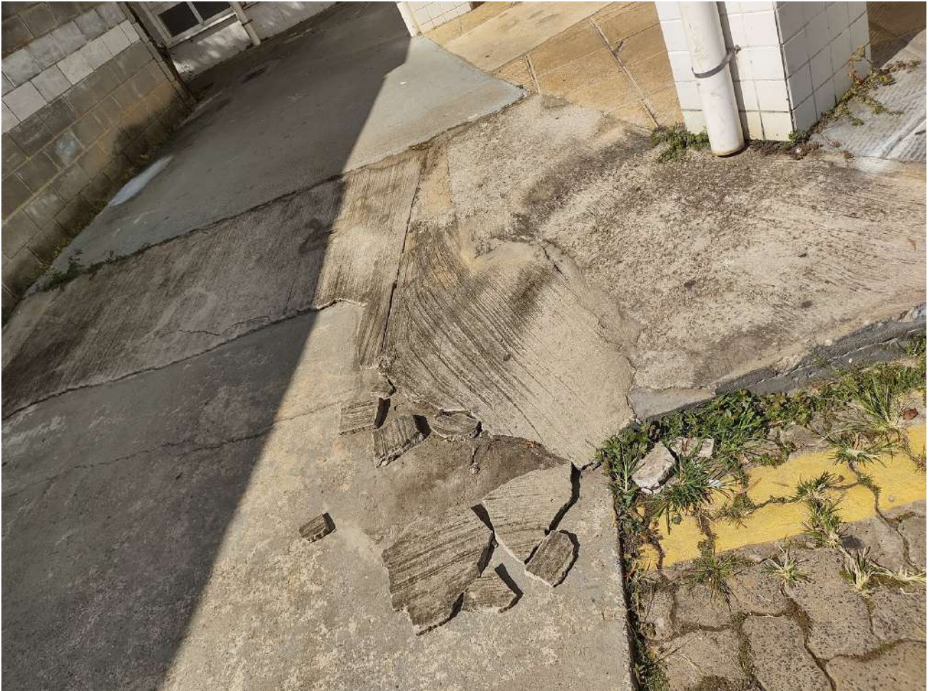
Piso externo danificado.
