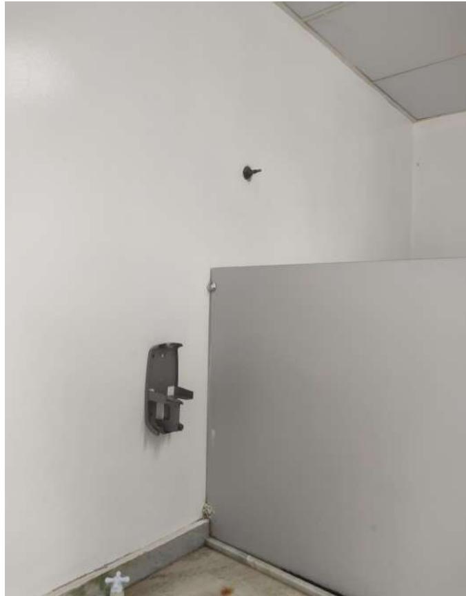
Detalhe da parede do banheiro com suporte quebrado/faltando
